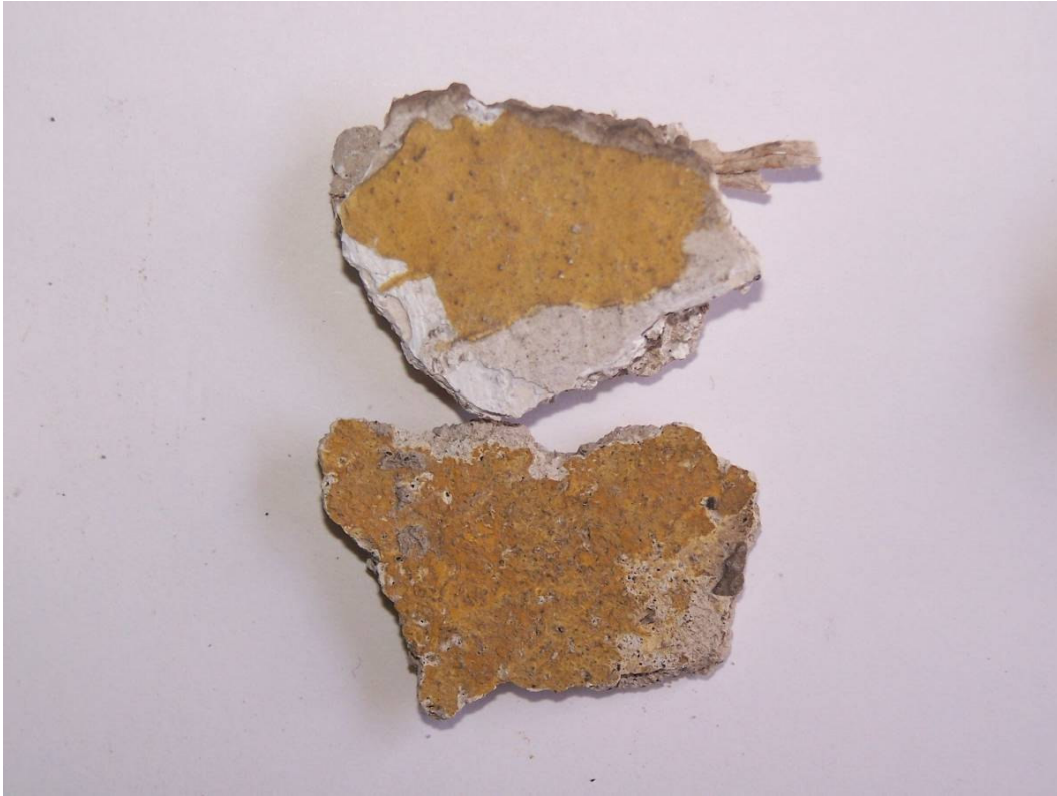
Foto 17. Particolare campione d'intonaco prelevato su Via De Filippo
