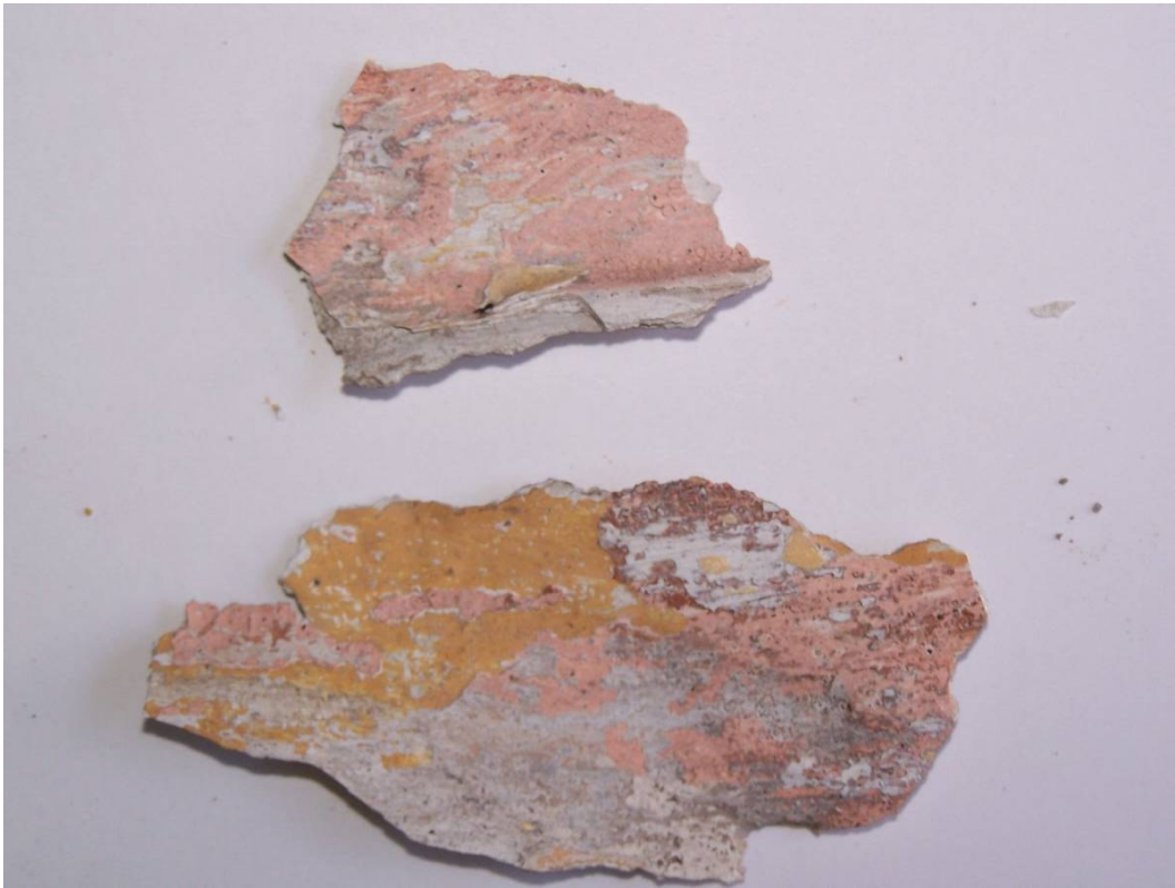
Foto 20. Particolare campione d'intonaco prelevato su Via De Filippo
